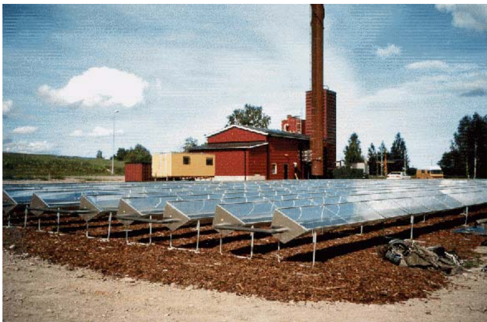
Figur 1 visar långa MaReCo solfångare installerade vid Hofors Energis fjärrvärmenät i Torsåker. Varje solfångare är 40 meter lång och 2 sådana solfångare är kopplade i serie. I detta system arbetar solfångarna vid temperaturnivåerna 55° intemperatur och 85° uttemperatur. Systemet togs i drift under våren 1999.
