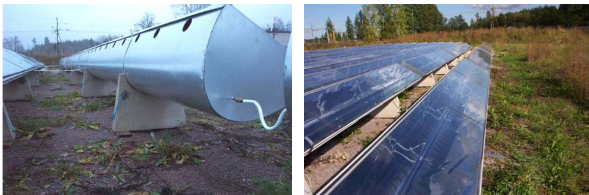
Figur 5, till vänster visas betongupplaget som solfångaren vilar mot. till höger ses de två sydligaste solfångarraderna som utgörs av den nya typen.
