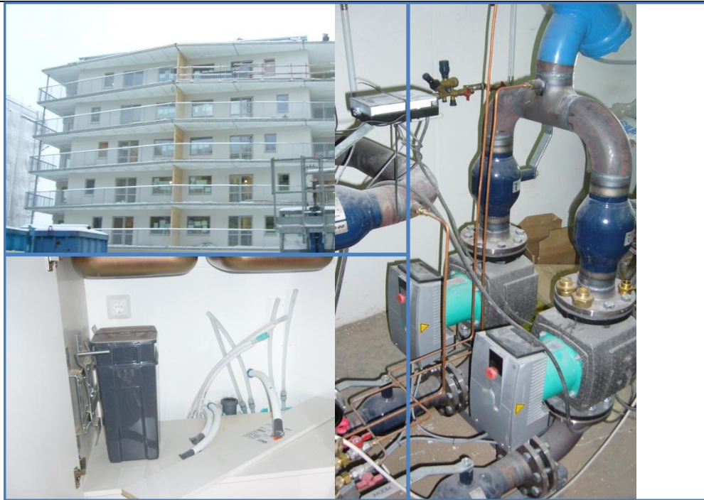
Figur 5.1. En av huskropparna i Råseglet i Västerås under uppförande där distributionssättet följer Västeråsmodellen (Figur 4.2), dock utan golvvärme i badrum. Till höger syns cirkulationspumparna för sekundärkretsen och nederst till vänster syns ett diskbänkskåp där ledningar för värme kretsen skall kopplas samman. Fotot togs i december 2012. Inflyttning sker i etapper under 2013.
