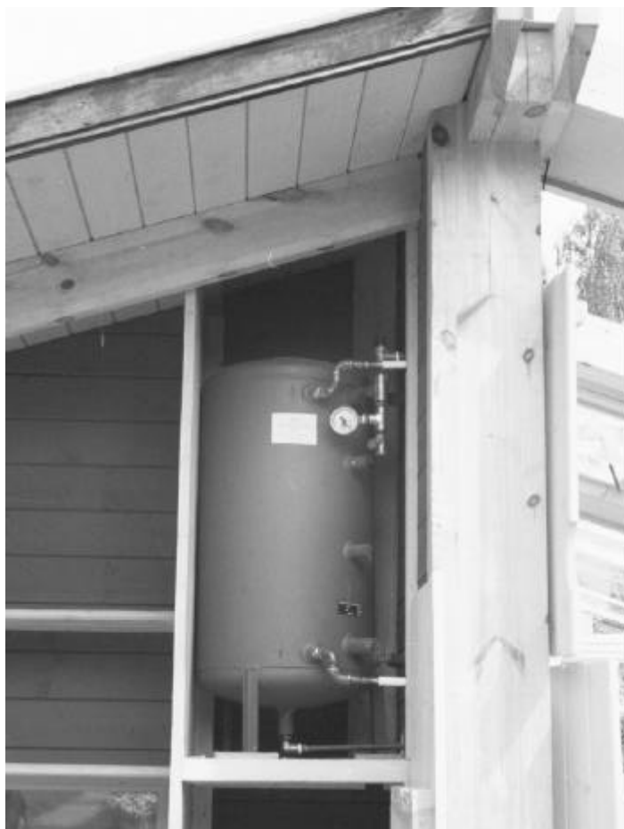
Bild 4.1. Den ännu oisolerade ackumulatortanken. Man kan se att den är placerad mot en trävägg, som utgör en köldbrygga och omöjliggör en fullgod isolering. Även röranslutningarna i tankens övre del utgör stora köldbryggor.
